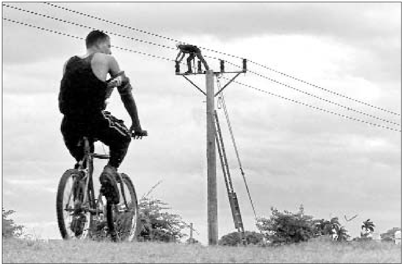
El sistema eléctrico de Cuba se ha visto sujeto a reparaciones constantes por las fallas en las termoeléctricas y el embate de huracanes
