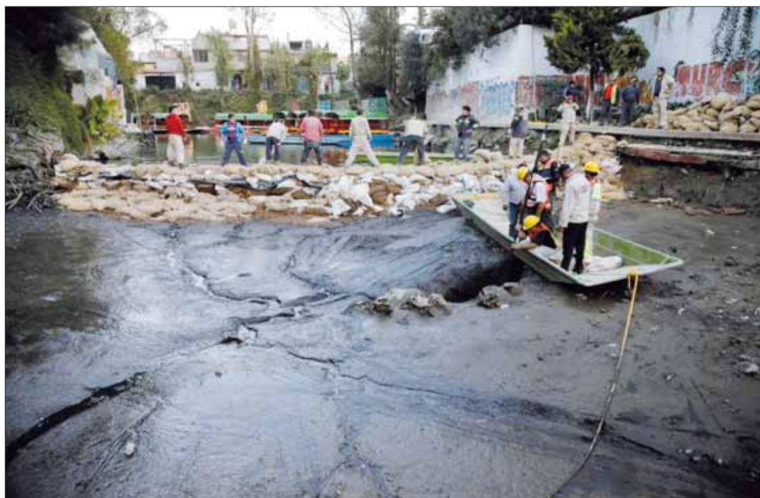
La formación de una grieta de tres metros en uno de los canales provocó que los niveles de agua en la zona bajaran alrededor de 25 centímetros, lo que afectó principalmente al embarcadero de Zacapa (imagen) y otros aledaños, como Nativitas y Nuevo Nativitas. Las autoridades colocaron costales de arena para evitar mayor pérdida del líquido, mientras geólogos buscan una solución ■ Foto Carlos Ramos Mamahua
